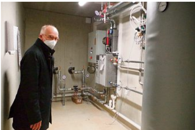
Sozialbau-Chef Herbert Singer zeigt die Heizungsanlage, die durch die Versorgung mit Nahwärme mit sehr wenig Platz auskommt.
